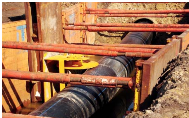
Fot. 4. Komora przy ul. Asfaltowej – zadanie C3
